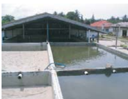
Hình 4: Bể lọc tự chảy
